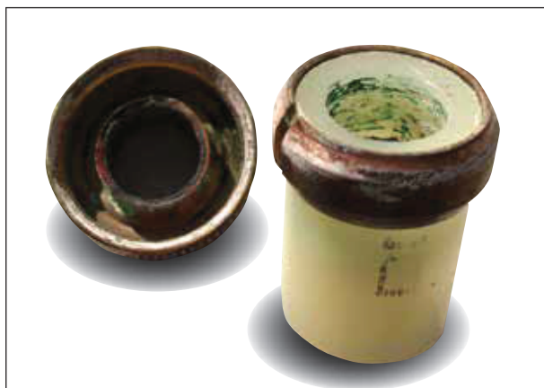
Kompressionsamling hvor støttebøsningen er korroderet væk.
