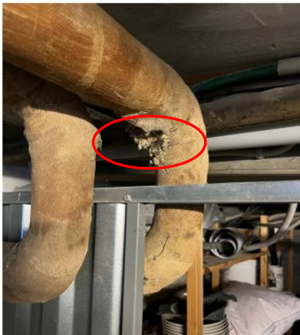
Brud på rørbøjning, asbest påvist.
