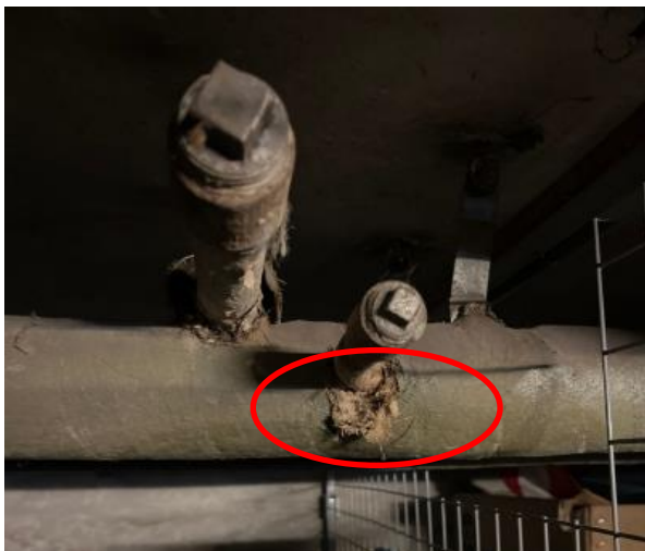
Brud på isoleringen med påvist asbest.
