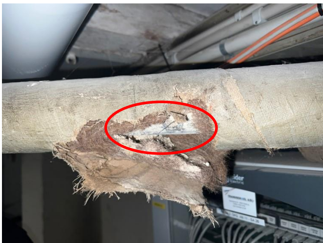
Det er det hvide/lyse, der er på røret, der er asbest
