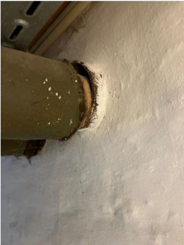
Brud på rør ved murhul, asbest påvist.
