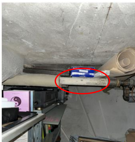
Brud på isoleringen med påvist asbest.
