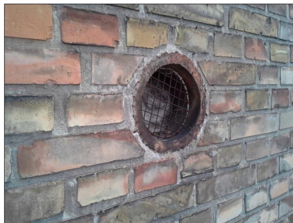
Udluftning i murværk
